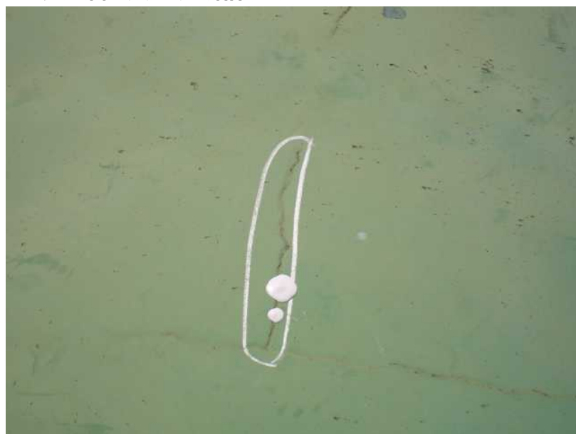
ガス検知箇所より防水材が噴出
