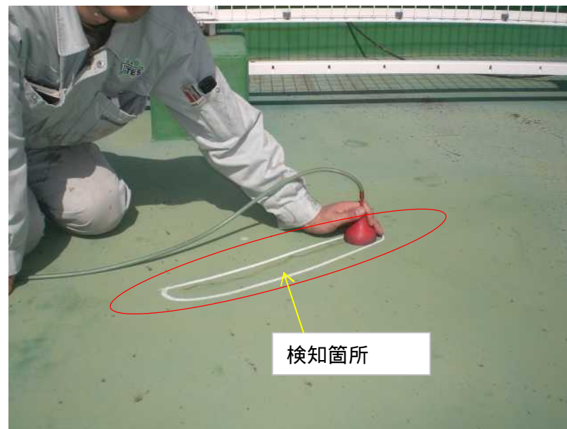
ガス検知箇所
