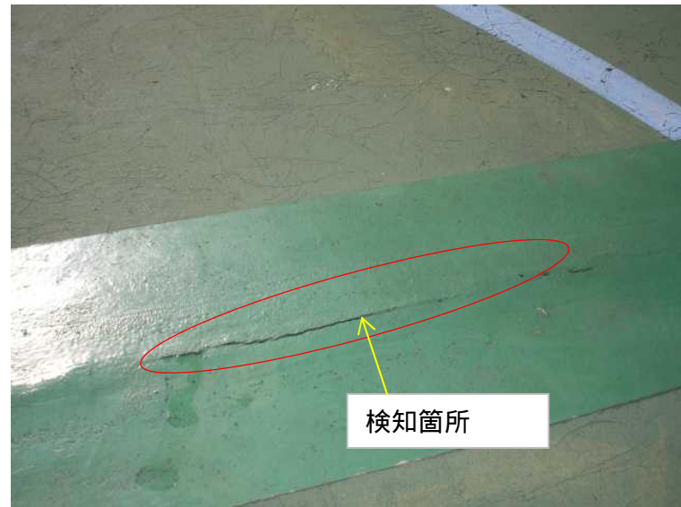
ガス検知箇所
