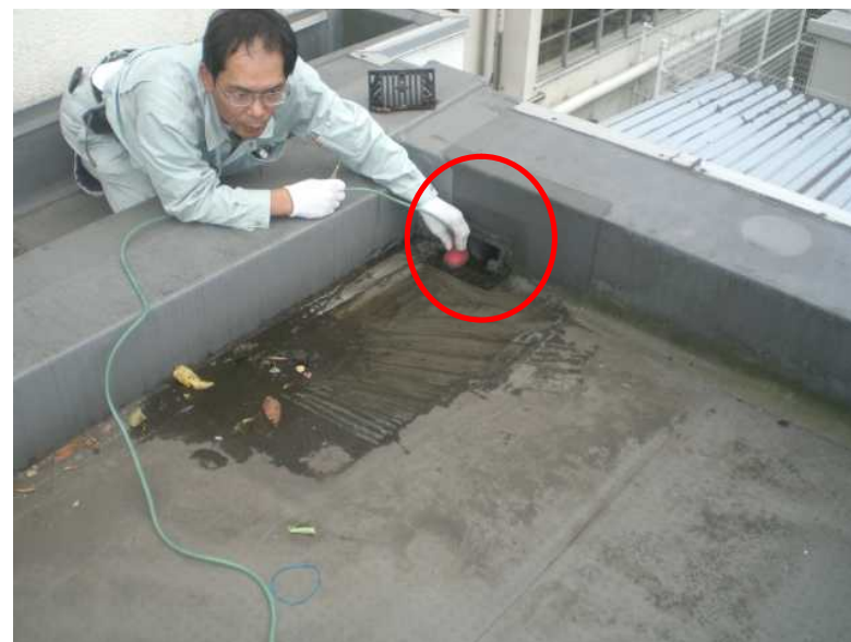
ガス検知箇所
